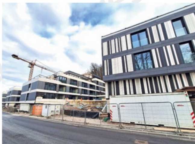
Novo naselje Devana park II pospešeno gradijo, primopredaje stanovanj pa naj bi bile predvidoma že konec tega leta.
